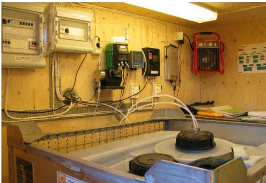
Figur 4.4 Anläggning för pH-justering av länshållningsvattnet från en av Botniabananans entreprenader. På bilden visas en tank för svavelsyra, doseringspump samt styr- och reglerutrustning. (Bild från rapport Tunnelvatten – Miljöeffekter och åtgärder).
